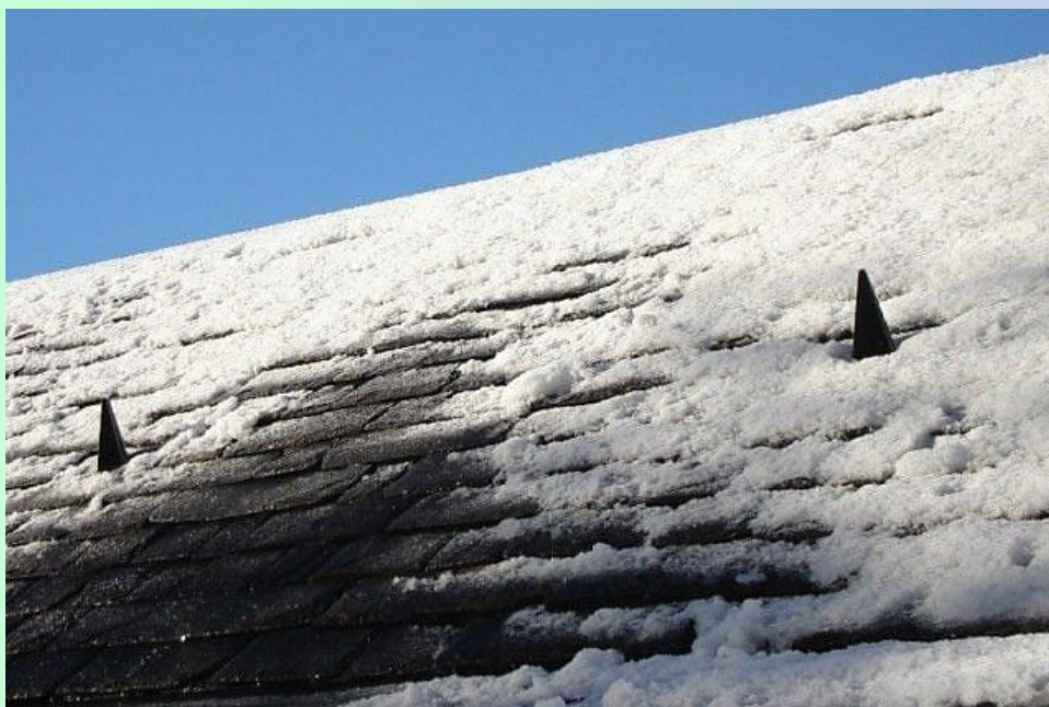
Pinchos destinados a evitar el desprendimiento de nieve en el tejado de una casa de Benasque (Huesca)
